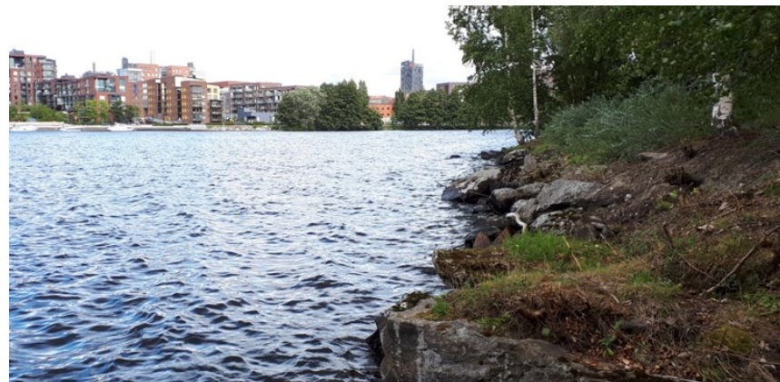
Kuva 2. Nykyinen rantaviiva on pääosin suojattu järjestämättömällä louheverhouksella. Paikoitellen rannassa on havaittavissa aaltoeroosion jälkiä.
